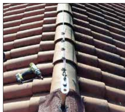
Foto di copertina e sotto: sistema linea vita installato a Monte San Pietro (BO).
